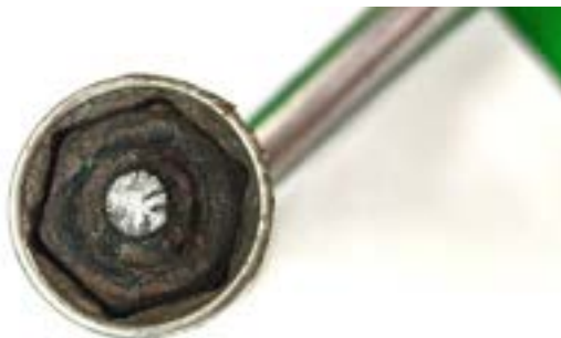
Рисунок 3 – Разрушение шпильки контрольного образца
