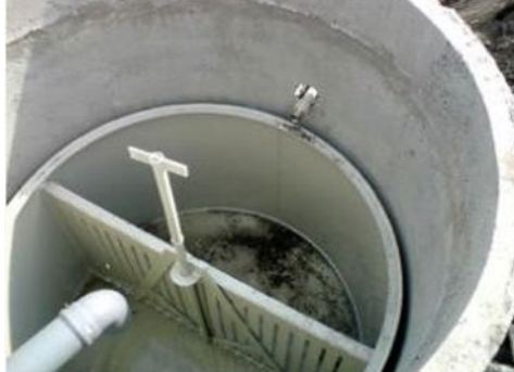
Рис. 1 – Резервуар для биологической очистки сточных вод
