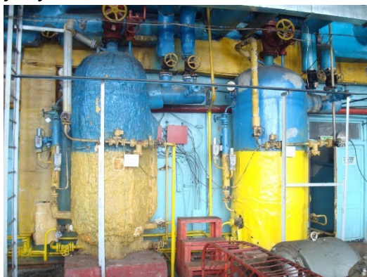
Рисунок 1- Фрагмент компрессорного цеха ОАО «Хладокомбинат Ульяновский»
