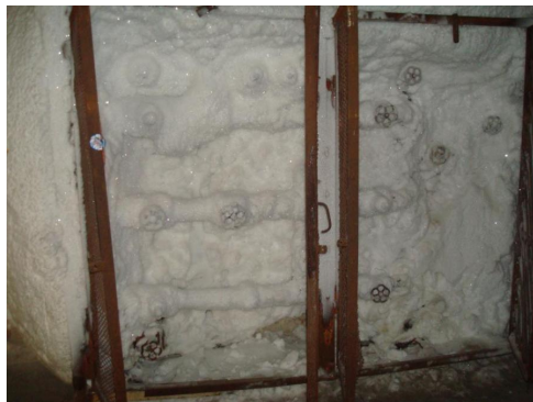
Рисунок 3- Распределительная станция холодильной установки
